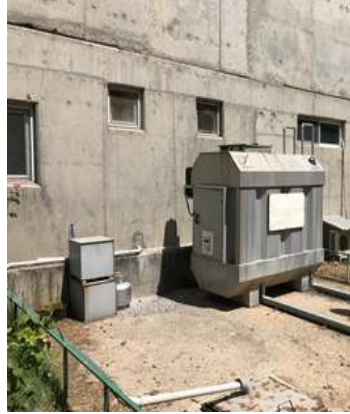
Foto 5: Dođankaya Hidroelektrik Santrali Paket Arıtma Tesisi (Adıyaman, 2020, F.A.KAPLAN)
